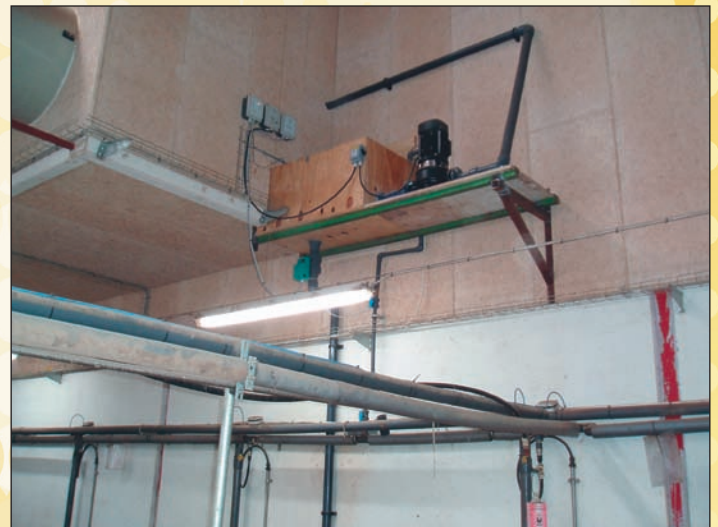
Ved siden af den lodrette skakt er der en lille sump, hvor procesvandet bliver kontrolleret og pumpet tilbage til selve luftrenseren.
