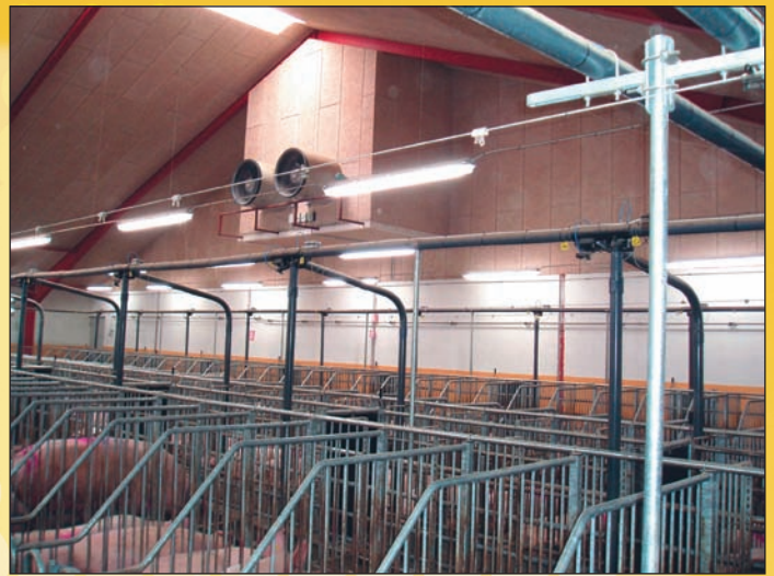
Den lodrette skakt passer fint ind i en stald med stålspær. Skakten er her fælles for løbe og drægtighed.
